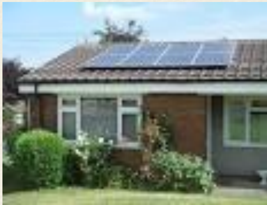
Pembangkit Listrik Tenaga Surya
